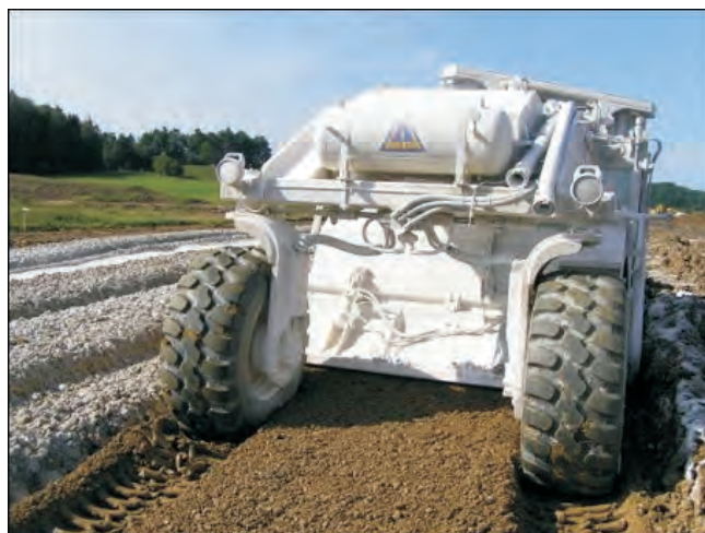
Obr. 160 Silnice I/48 Tošanovice-Žukov – úprava zemín (deluviální jíly CI) na první vrstvě násypu (05/2005)
