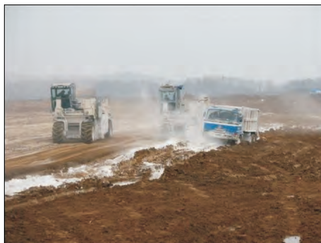
Obr. 162 Terénní úpravy v místě automobilky Hyundai v Nošovicích – úprava silně převlhčených zemín (sprašové hlíny CI) vápnem v násypu pod budoucí výrobní halou (01/2007)
