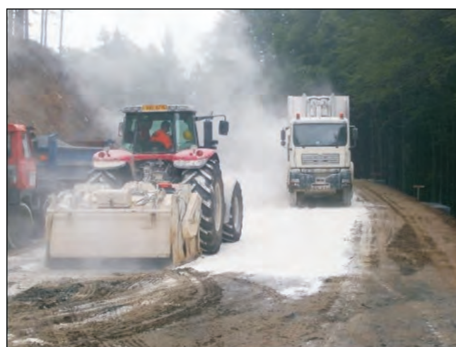
Obr. 161 Silnice I/44 Červenohorské sedlo - sever – úprava zemín (deluviální jíly s úlomky hornin, CI, CG) vápnem v násypech pro rozšíření komunikace (06/2008)
