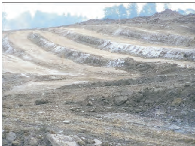
Obr. 158 Silnice I/48 Tošanovice-Žukov – úprava zemín (deluviální jíly CI) vápnem v podloží svahových stupňů nového násypu na svahu (05/2005)
